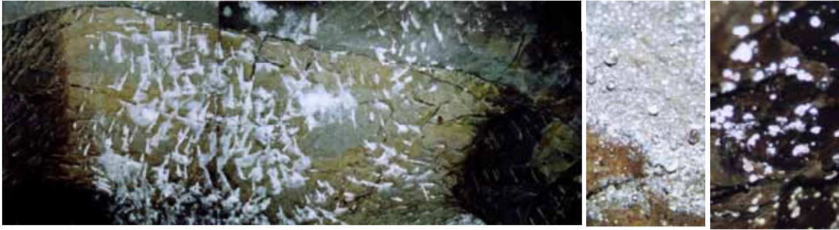
写真 12 天井と壁面上部の変色帯および菌類と推測される白色の物質
